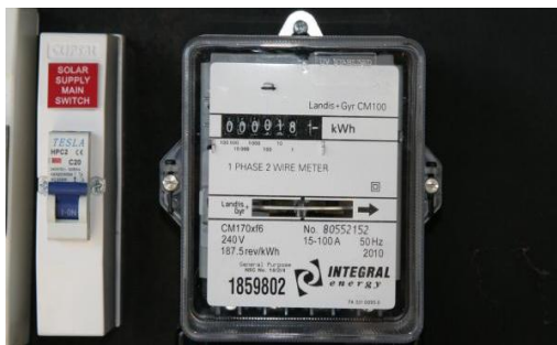
Electricity Meter མི་ཐར།
